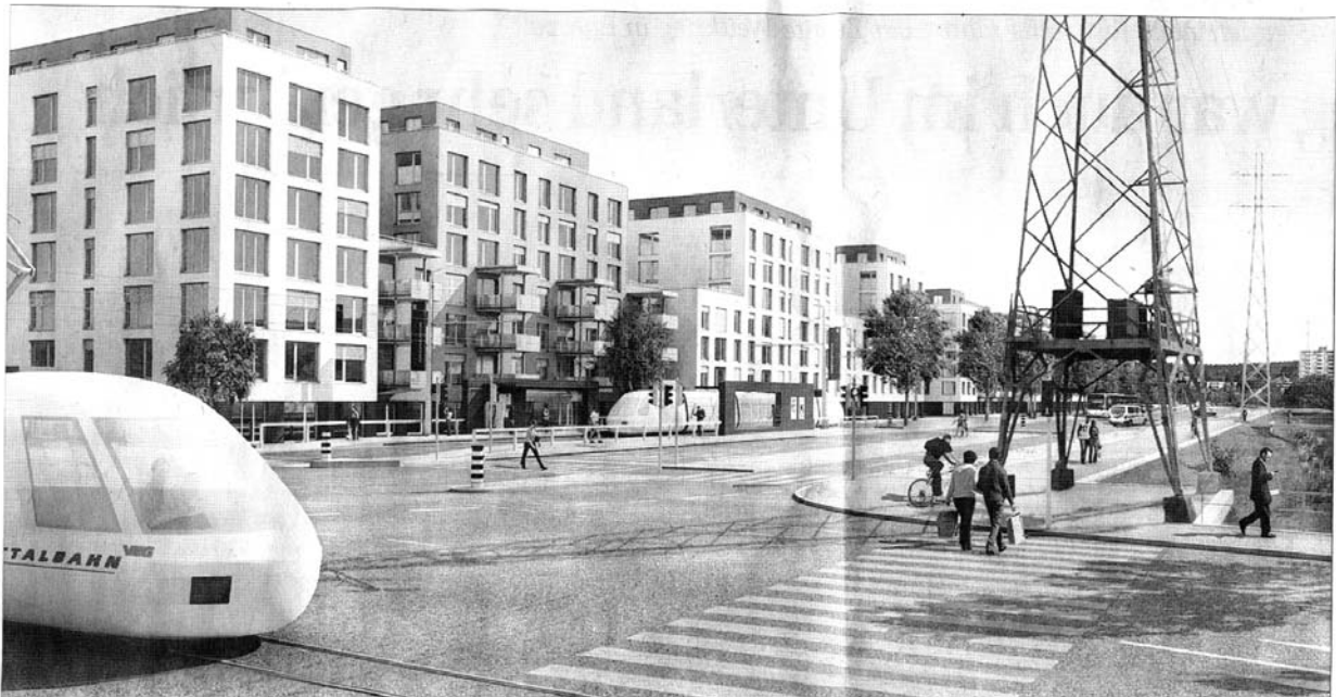
Für den Bau der Glattalbahn müssen Werkleitungen neu verlegt werden. Die Kosten dafür tragen laut Bundesgericht die Verkehrsbetriebe Glattal.
